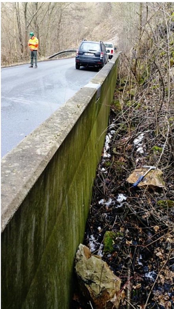
Foto 6 Pohled do prostoru za betonovými svodidly typu NEW JERSEY dokazuje, že v zájmové oblasti dochází k neustálému opadu úlomků hornin o velikosti do 50 cm. Dle ústního sdělení Ing. Tomáše Lehečky plní svodidla v blízkosti lokality svou funkci již osm let.
